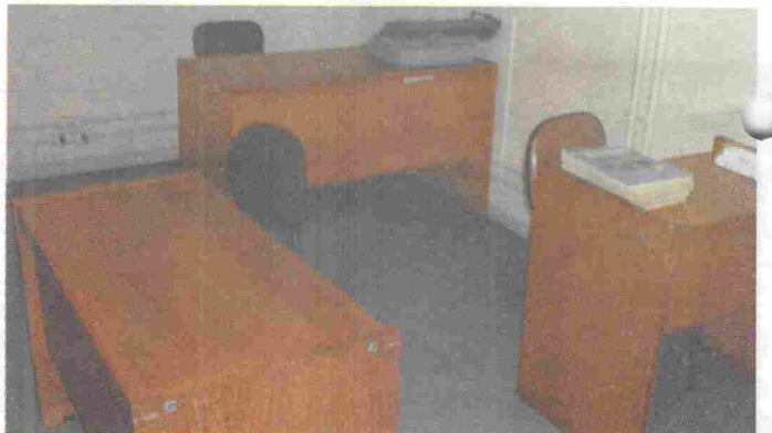
Sala dos oficiais de justiça no fórum conta ainda com máquinas de escrever (danificadas) e móveis em mau estado de conservação
